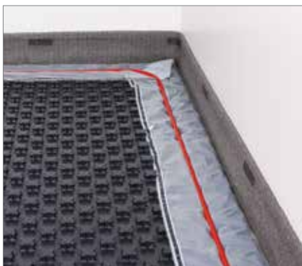
8. Detail pokládky trubky RAUTHERM S u stěny
