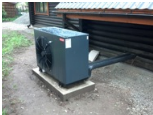
Horská chata, Estonsko, HOTJET 15ONE/EVI, HYDROBOX 300.
